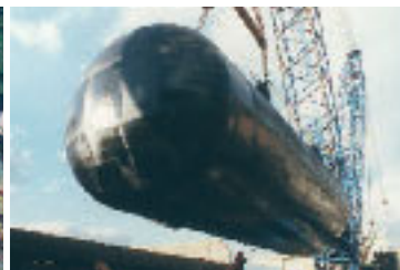
Depósitos: Recubrimiento exterior de un depósito para la industria
