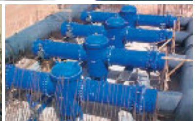
Proyecto Great-Man-Made-River en Libia: Abastecimiento de agua - Recubrimiento de una unidad de distribución con PROTEGOL®UR 32-55
