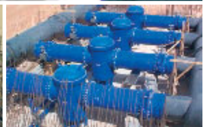
Projecto Great-Man-Made-River, na Líbia: abastecimento de água – revestimento de uma estação de distribuição com PROTEGOL®UR 32-55
