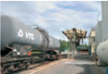
Verladestation für Kesselwagen und Tankwagen
